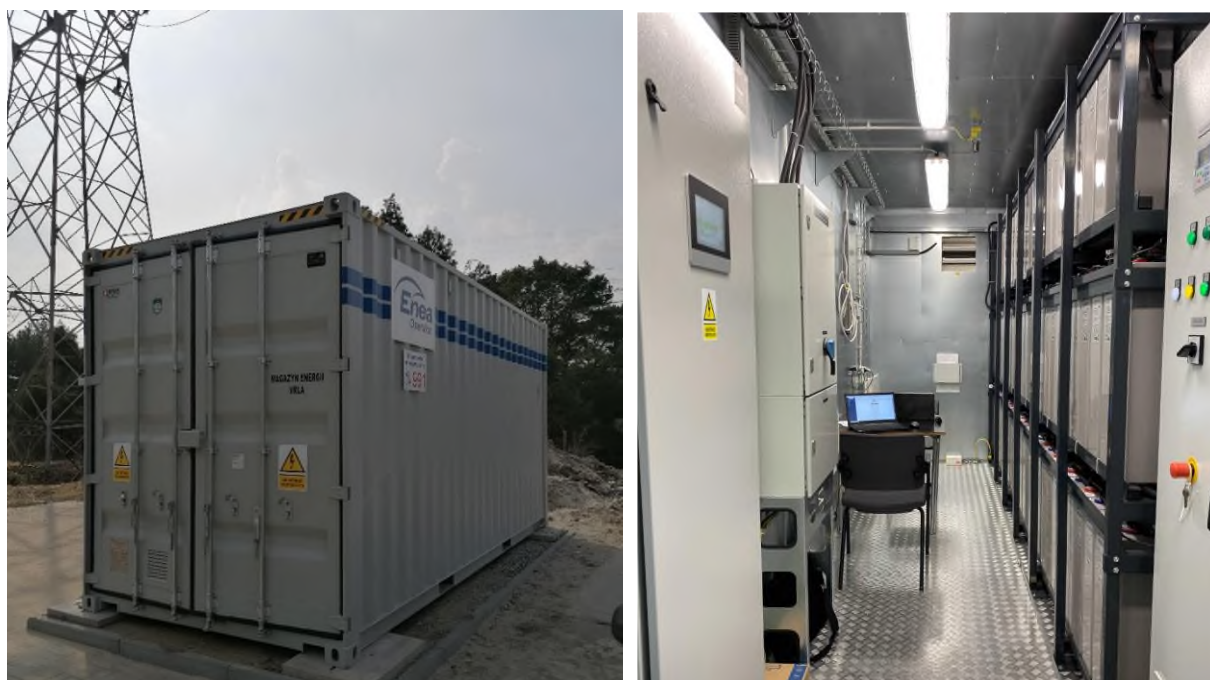
Rysunek 104. Przykład infrastruktury magazynów energii w zasobach OSD. Źródło: opracowanie własne
