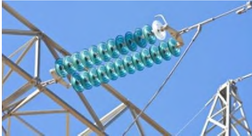
Rysunek 38. Rozmieszczenie szklanych izolatorów na sieci dystrybucyjnej. Źródło: opracowanie własne
